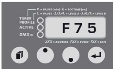
Abb. 10: Einstellen des Lüfters (Fan)-Wertes
